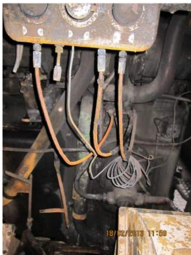
Fig.2 Zona aparatelor din sala masinii avariate
